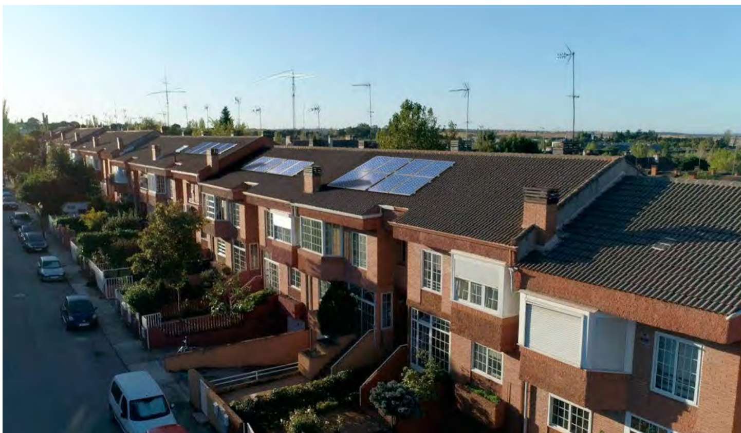
Placas de autoconsumo instaladas por Iberdrola en varios edificios de viviendas. / E.M.
