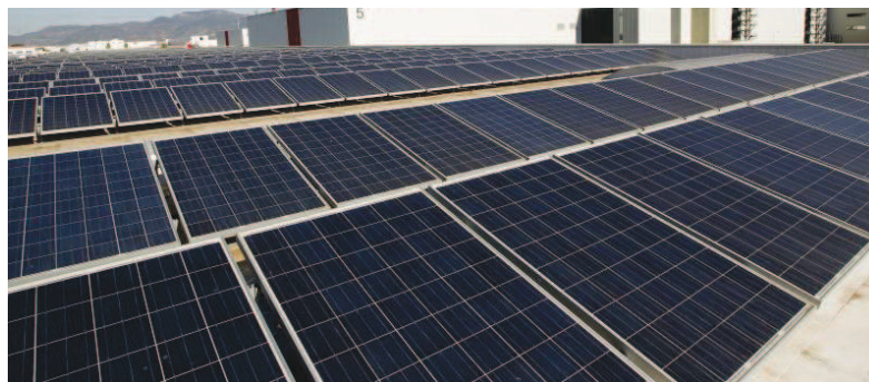
Placas solares en el tejado de una fábrica de Barcelona. / JORDI SOTERAS
